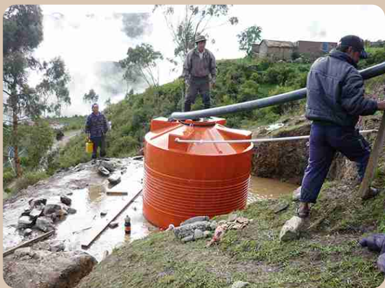
Tanque con capacidad de almacenamiento de 5.000 litros.
